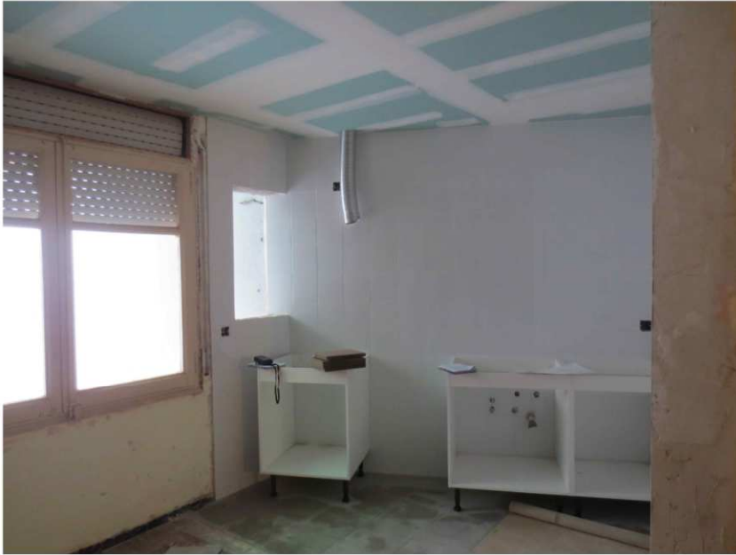
Cuina. Comencem a col·locar els mobles i el tub d'extracció ja està instal·lat.
